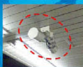
地下鉄対策用アンテナ局
