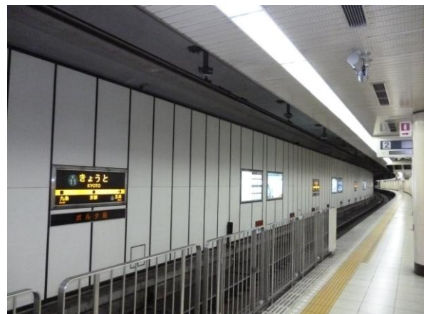
ホームに設置されたアンテナ
